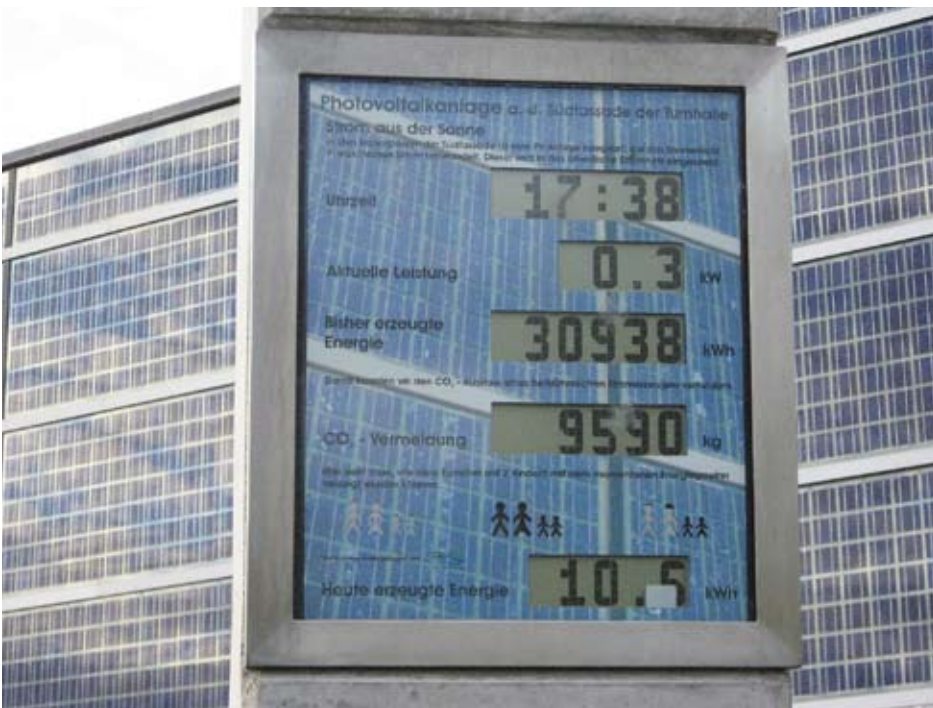
Messstation zur Photovoltaikanlage
